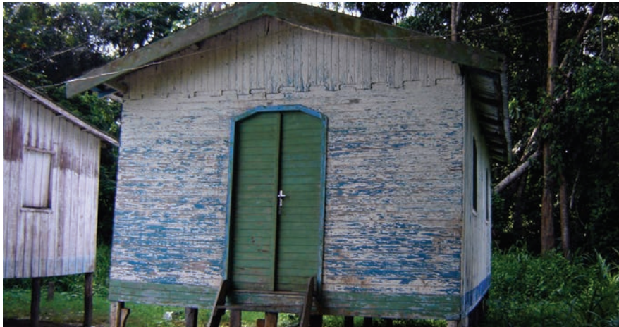
FIGURA 27. IGREJA DA COMUNIDADE, LOCALIZADA EM ÁREA DE DESBARRANQUEAMENTO. Fonte: NUSEC/UFAM (2006).
